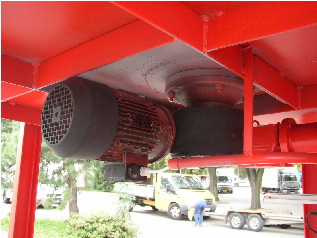
Obrázek č. 6 Převodovka s motorem rozrušovače klenby v zásobníku u kotle o výkonu 100 kW
