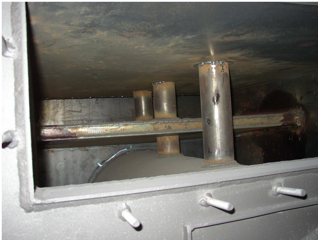
Obrázek č. 9 Usměrňovač spalin u automatického kotle o výkonu 150 kW
