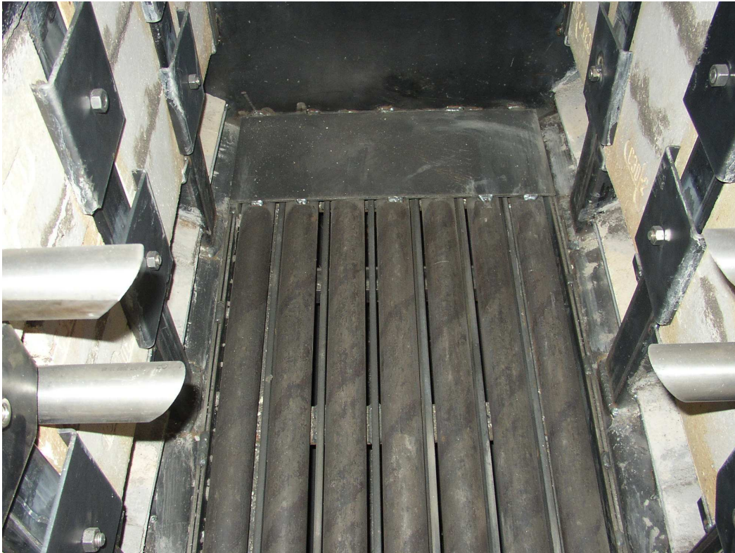
Obrázek č. 8 Pohled do spalovací komory s roštovacím zařízením, šamotovou vyzdívkou a nerezovými trubkami laserových snímačů u kotle o výkonu 150 kW
