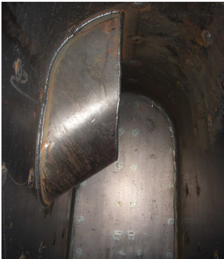
Obrázek č. 7 Pohled do spalovací komory automatického kotle o výkonu 150 kW
