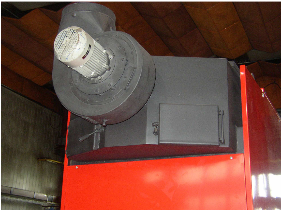
Obrázek č. 11 Spalinový odtahový ventilátor u kotle o výkonu 150 kW
