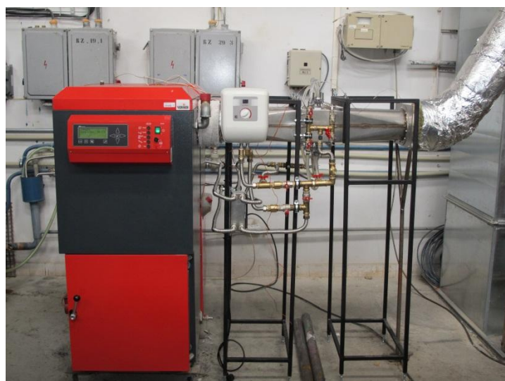
Obr. 4 Pohled na sestavenou jednotku termoelektrického generátoru s jedním segmentem
