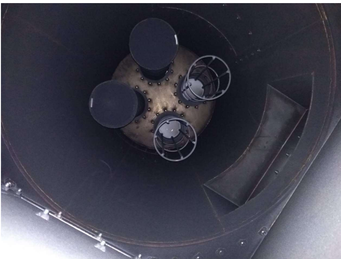
Obr. 6: Filtrační patrony po provozním měření
