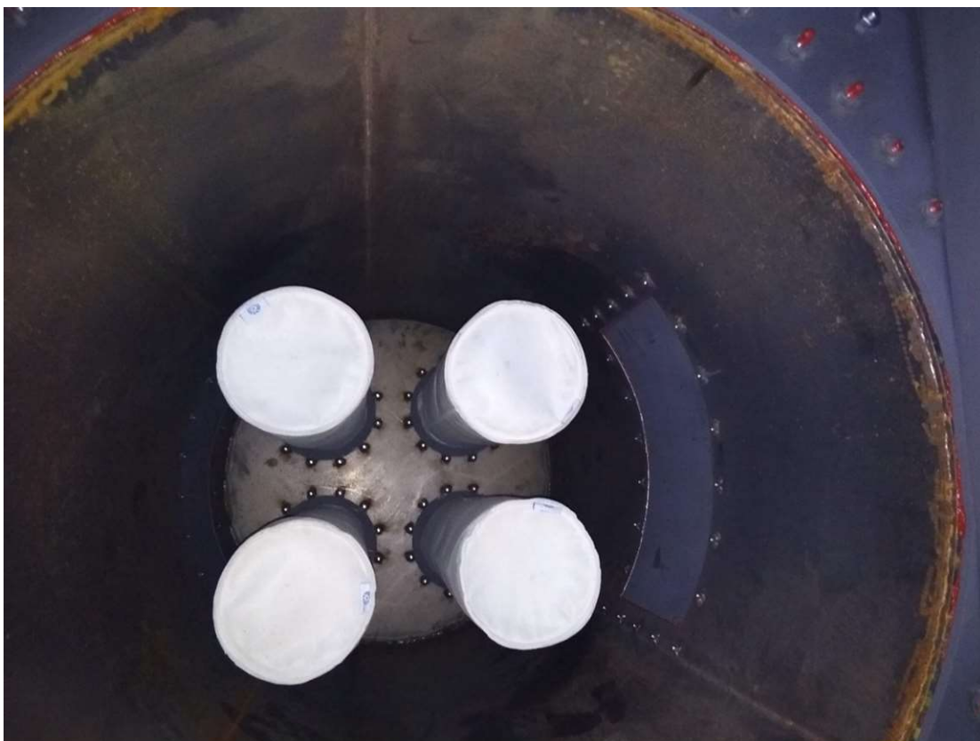
Obr. 5: Filtrační patrony před provozem
